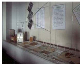
▲展示室ガラス破損
